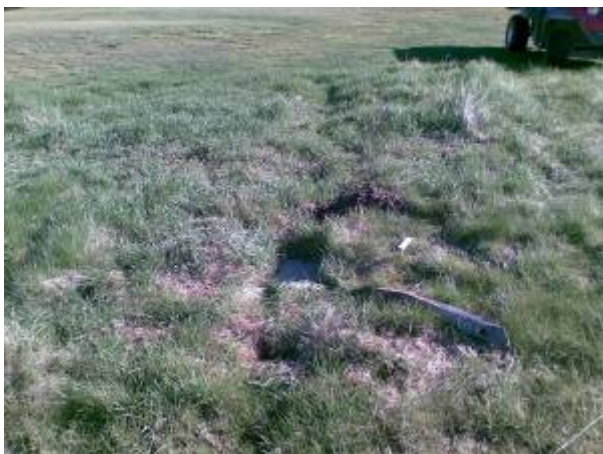
Så här ska det inte se ut runt en kabelbrunn!
